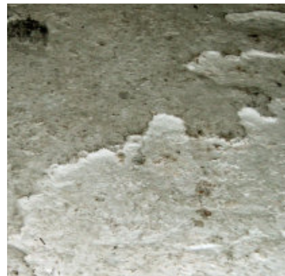
Croûte séchée de polymère, dure et compacte.
